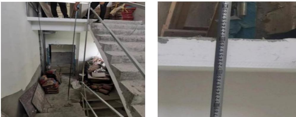
图 5 作业面至坠落面高度（330cm）测量图
